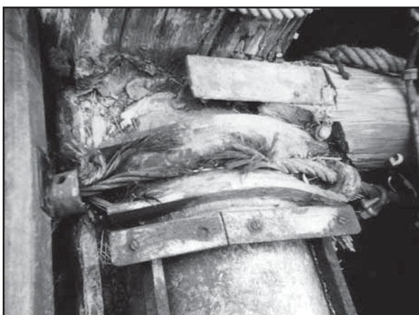
Figur 33: Bru festepunkt fra en fornøyelse-spark. Oppsamlet vann som blir liggende på brua er med på å utvikle betydelig korrosjon.
