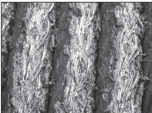
Figur 137: ...dette ståltauet måtte kasseres (se figur 136). Nærmere undersøkelse viste at hver yttertråd hadde brudd for hver tredje cm.
